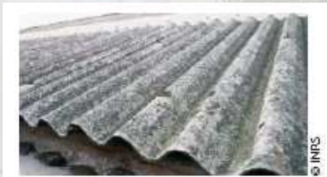
Toiture en amiante-ciment
